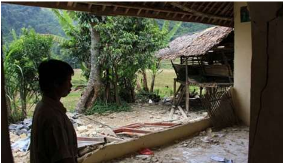
Gambar 2. Kondisi Bangunan Warga Pasca Gempa di Kampung Muara, Desa Cibunian
