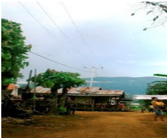
Lampiran 3. Kondisi jaringan listrik di pedesaan
