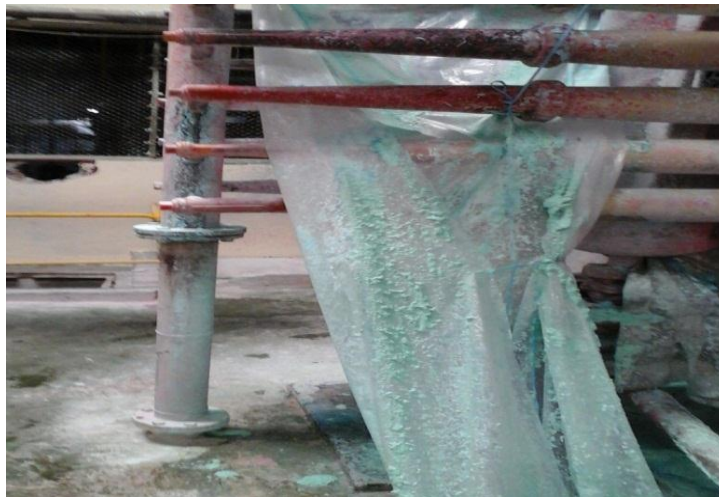
Gambar 14 Kebocoran centricleaner pada area paper machine
