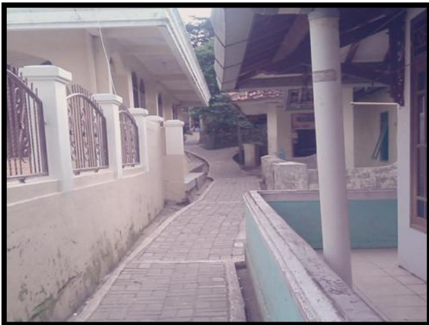
Kondisi Jalan Desa
