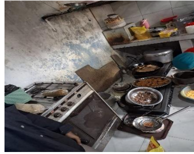
Gambar 4 Dinding kotor dan retak
