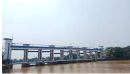
Gambar 3 Bendungan Pasar Baru
