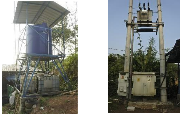
Gambar 6 Toren air dan Trafo PLN
