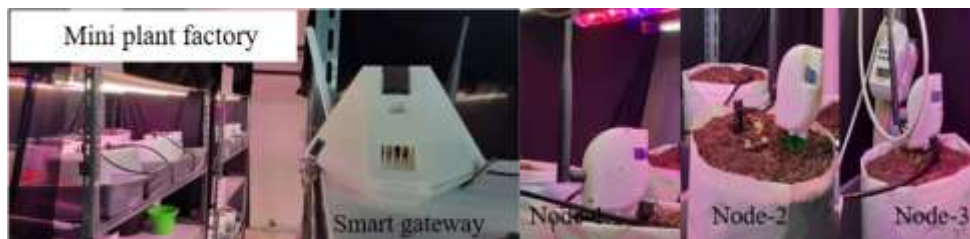
Gambar 23. Instalasi node dan gateway di dalam plant factory
