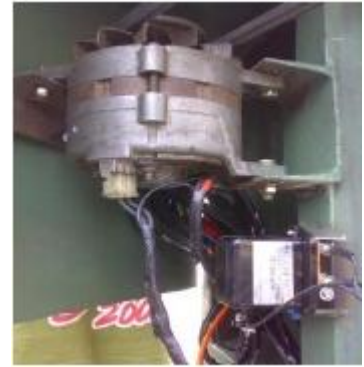
generator dan tahanan
