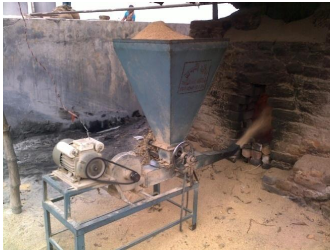
Gambar 2. Tungku untuk pembangkit steam
