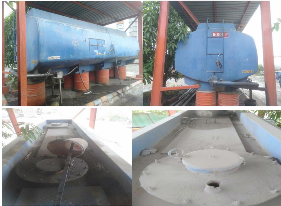
Gambar 47. Kondisi main tank B30
