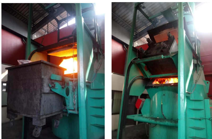
Gambar 7 Proses pembakaran sampah di insinerator BISH
