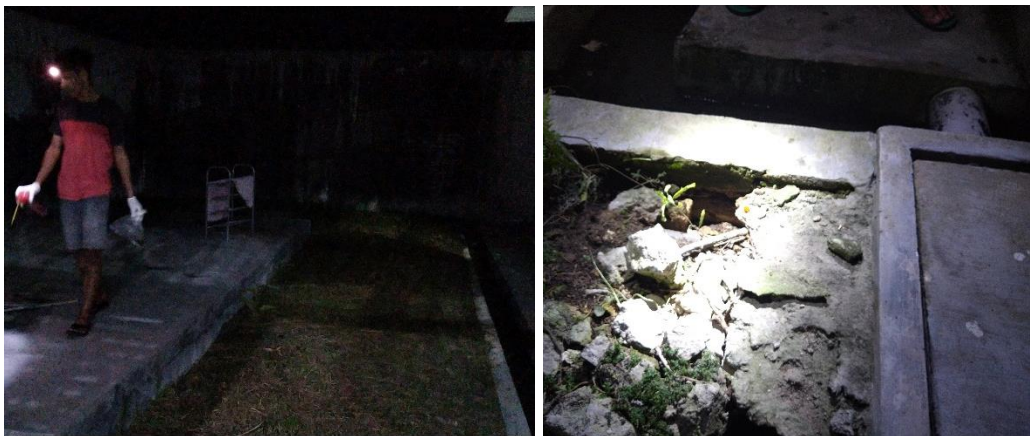
Gambar 3 Saluran Limbah (A) dan Genangan Air dan Retakan pada Saluran Limbah (B)
